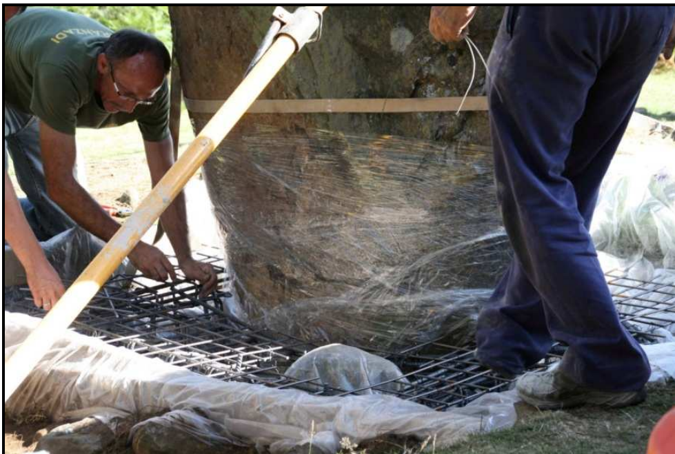
Ultimos detalles en la armadura y colocación de film plástico en el monolito
